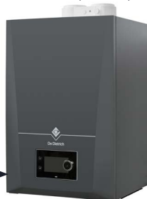
Chaudières 1 à 7 (suiveuses)
